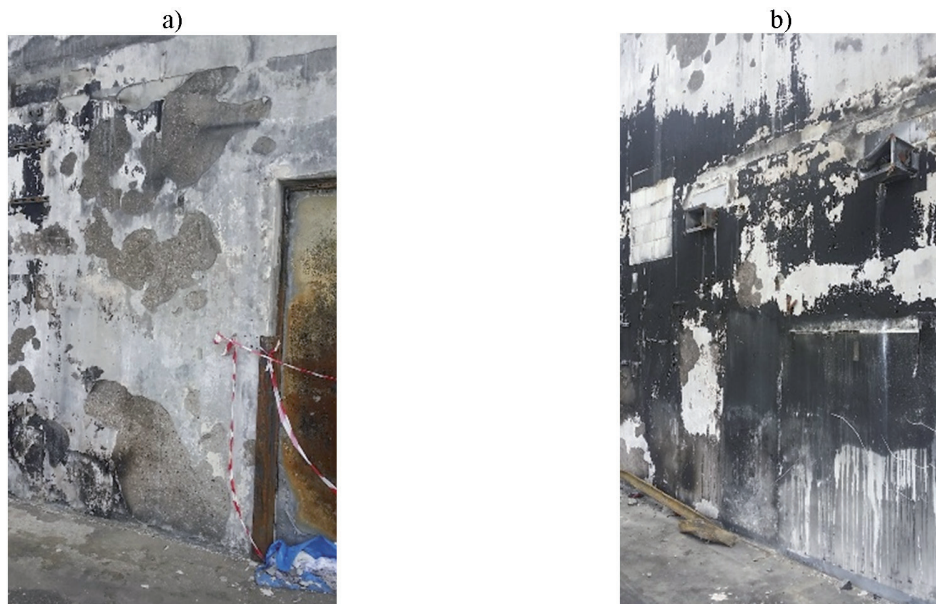
Fot. 2. Widok ściany pożarowej: a) widoczne odspojenia otuliny, b) ślady sadzy i osmolenia
