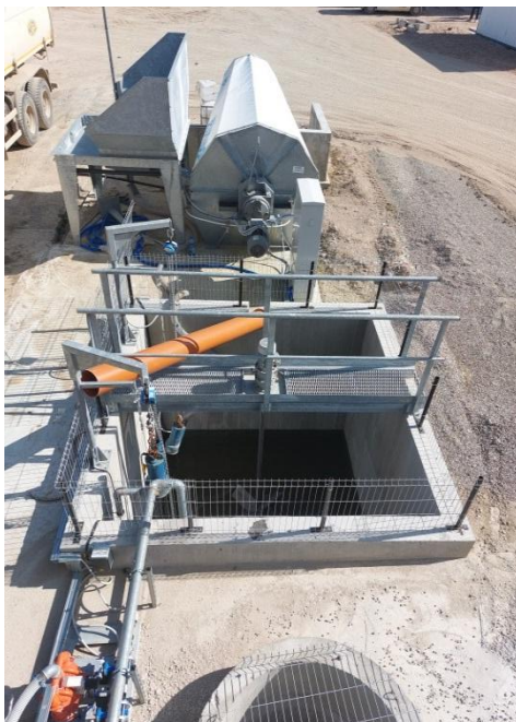
Fot. 2 Stanowisko mycia sprzętu, separator BETONWASH i zbiornik zawiesziny
