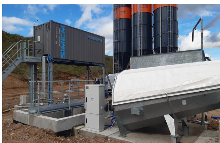
Fot. 1 Zespół recyklingu BETONWASH + WATERWASH
