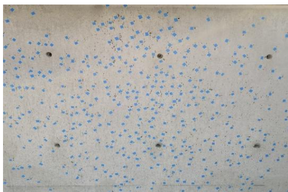
Fot. 2 Dokumentacja ubytków powierzchni, BEKO Betondesign (S. Wieczorek)
