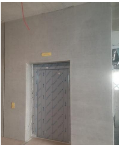
Fot. 5 Powierzchnia betonu po Betonkosmetik, BEKO Betondesign (A. Huhn)
