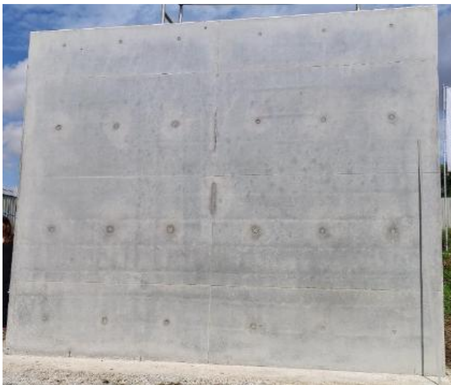
Fot. 6. Niebieskie przebarwienia na betonie z cementem hutniczym
