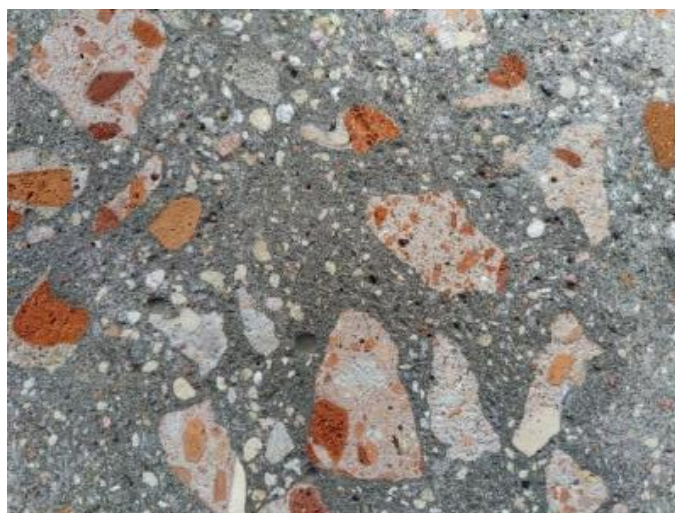
Fot. 18. Beton z wtrąceniami z betonu recyklingowego na bazie kruszywa ceglanego
