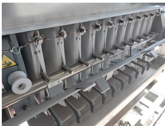
Fot. 4 Prasa filtracyjna
