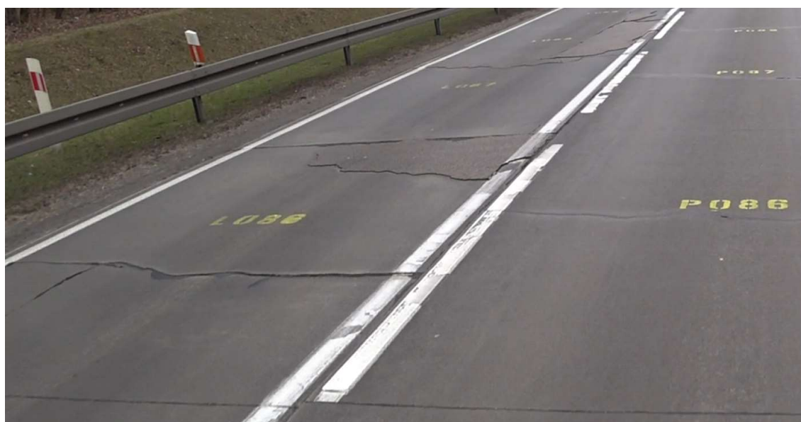
Rys. 3. Wybrane uszkodzenia nawierzchni betonowej – pęknięcia płyt (archiwum własne).
